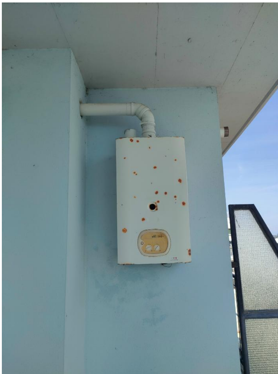
Particolare Caldaia Murale Esterna su balcone Nel balcone è presente anche rubinetteria per lavatoio esterno
