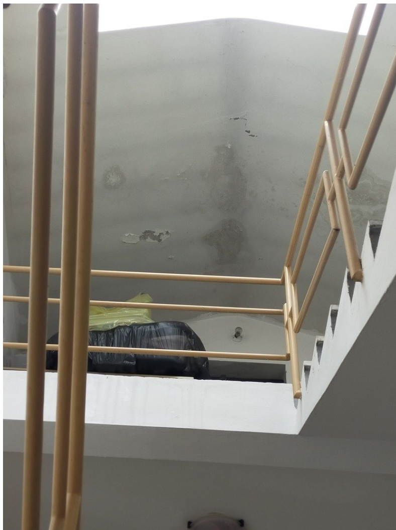
- TRACCE INFILTRAZIONI ZONA SOTTOTETTO -
