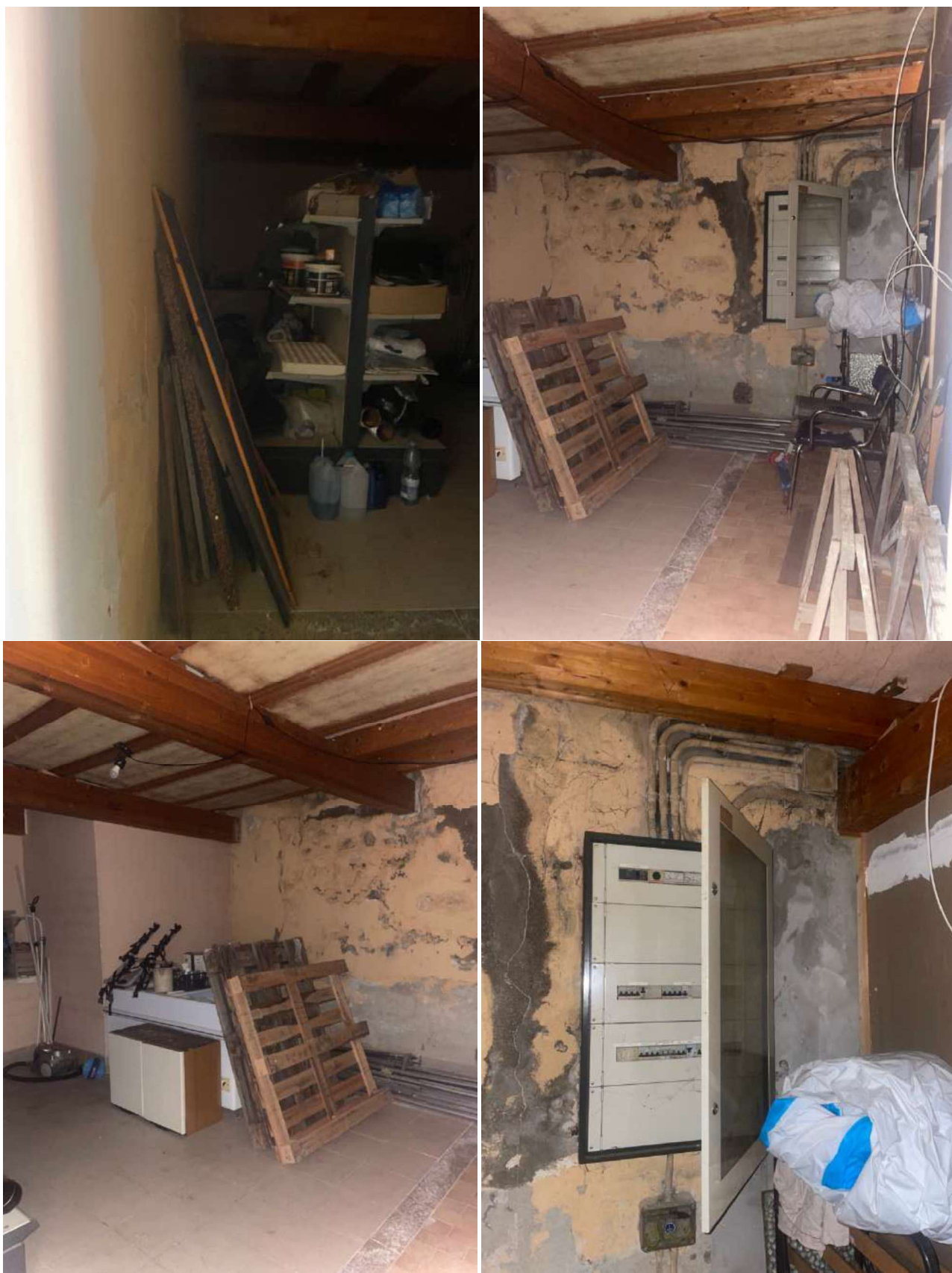
Figura 7 - 10: INTERNO DEL LOCALE MAGAZZINO RICAVATO PER L'ATTIVITA' COMMERCIALE ADIACENTE – VISTA DEL QUADRO ELETTRICO GENERALE
