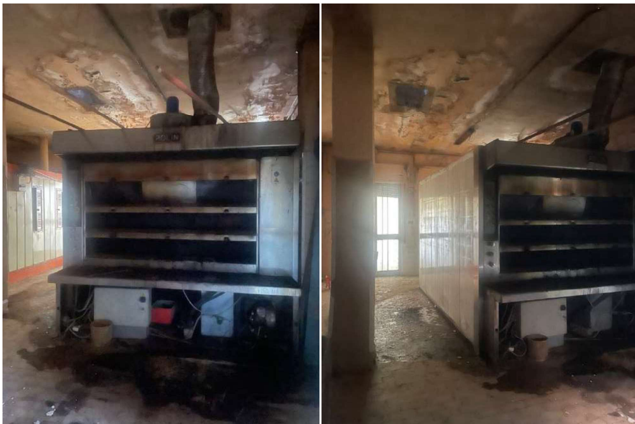
Figura 12 – 14: INTERNO DEL LOCALE DI PANIFICAZIONE - VISTA ZONA FORNI
