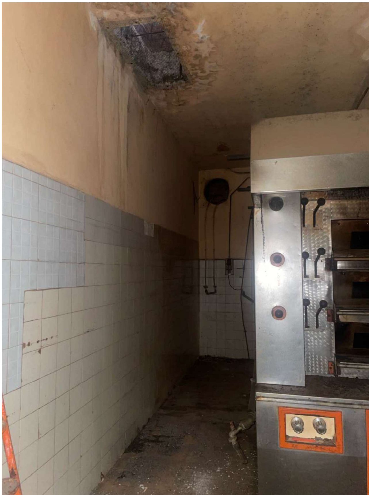
Figura 55: DETAGLIO INFILTRAZIONI NELLA ZONA DEL FORNO DI SINISTRA ( PER CHI ENTRA DALL'INGRESSO PRINCIPALE)
