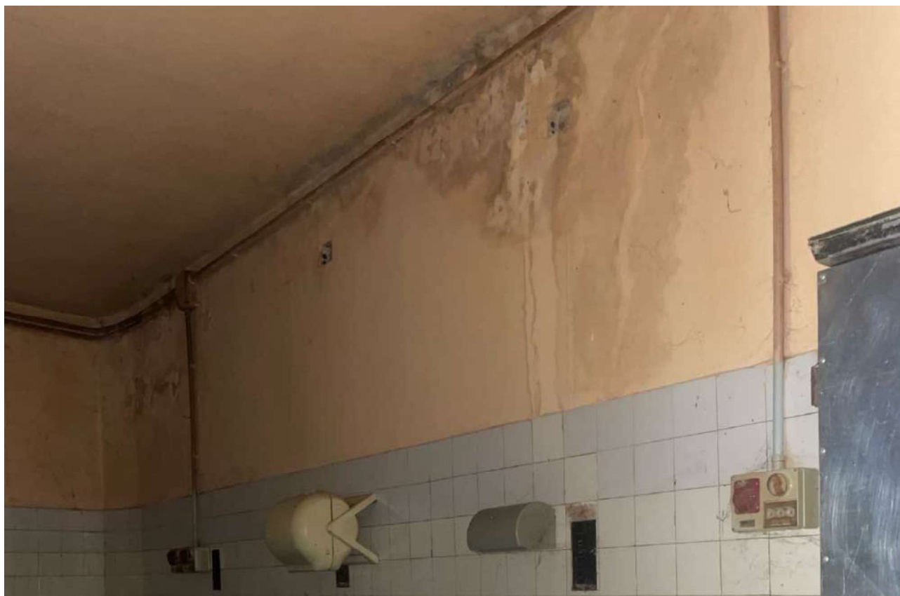
Figura 52: DETTAGLIO INFILTRAZIONI NELLA ZONA DI PANIFICAZIONE
