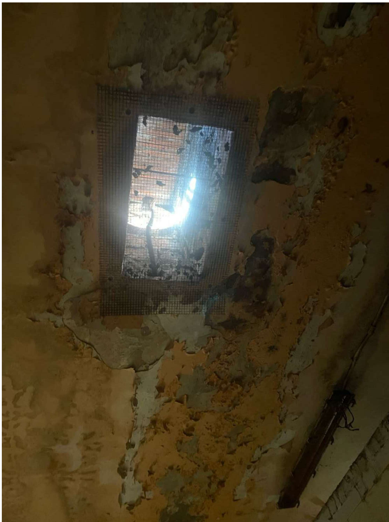
Figura 57: DETTAGLIO INFILTRAZIONI DAL LUCERNAIO
