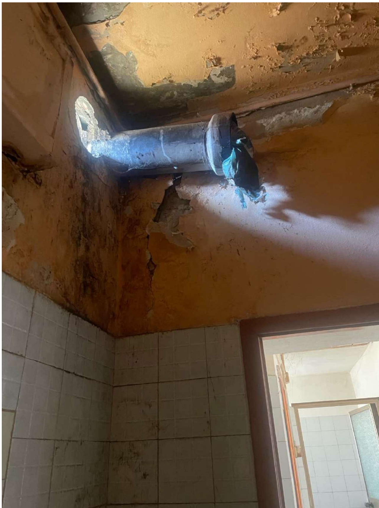
Figura 58: DETAGLIO INFILTRAZIONI DAL PIANO DI COPERTURA IN PROSSIMITA' DELL'INGRESSO AI SERVIZI IGIENICI
