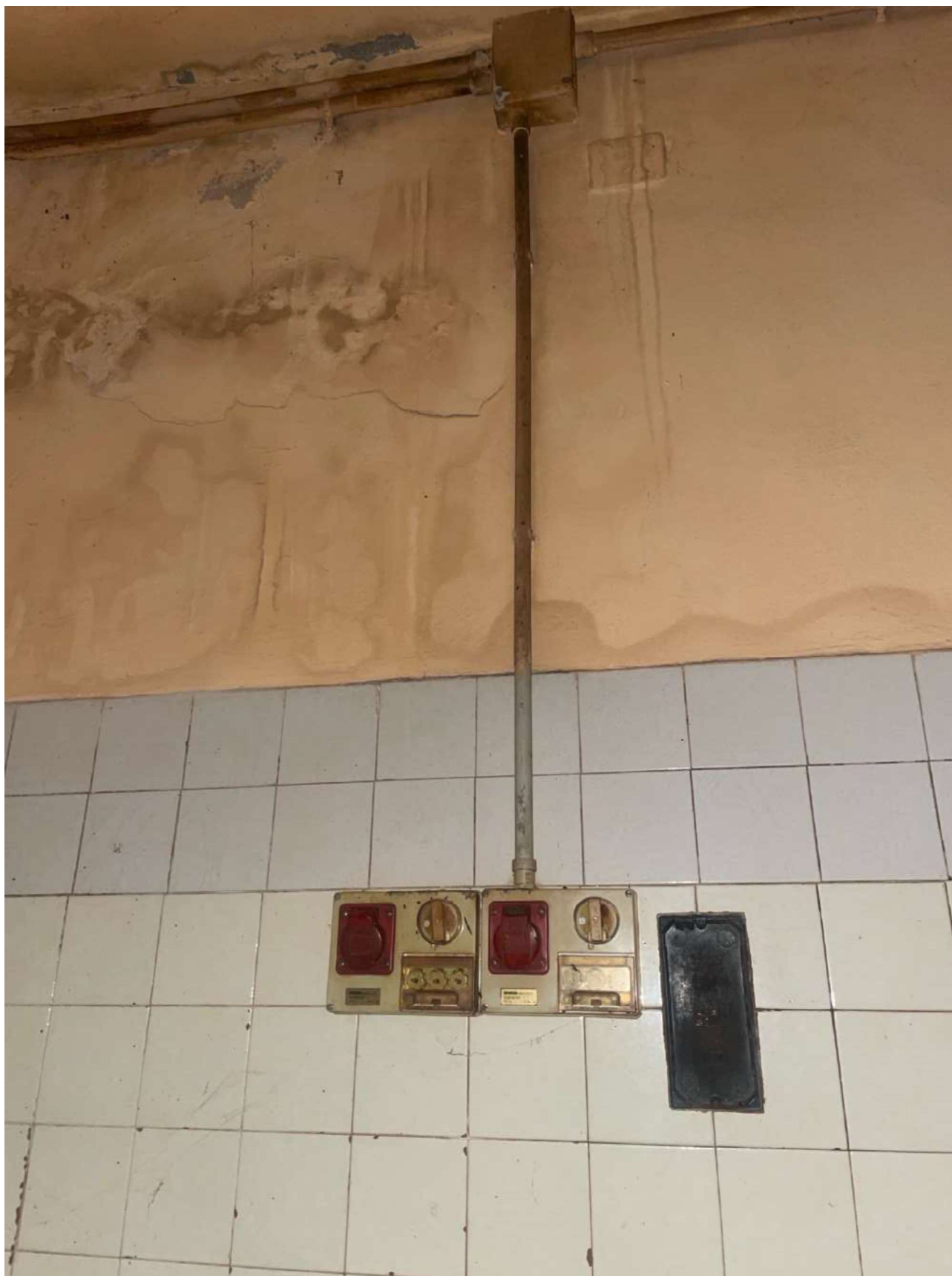
Figura 54: DETTAGLIO INFILTRAZIONI NELLA ZONA DI PANIFICAZIONE
