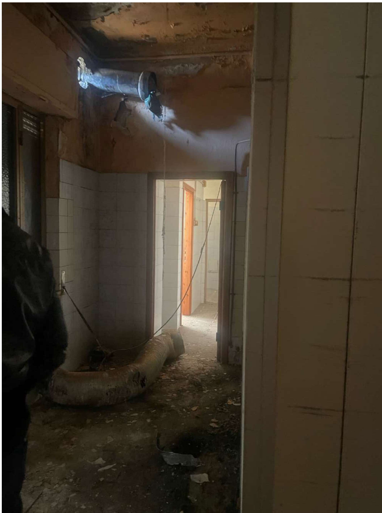
Figura 49: DETTAGLIO INFILTRAZIONI IN CORRISPONDENZA DELL'INGRESSO ALLA ZONA DEI SERVIZI
