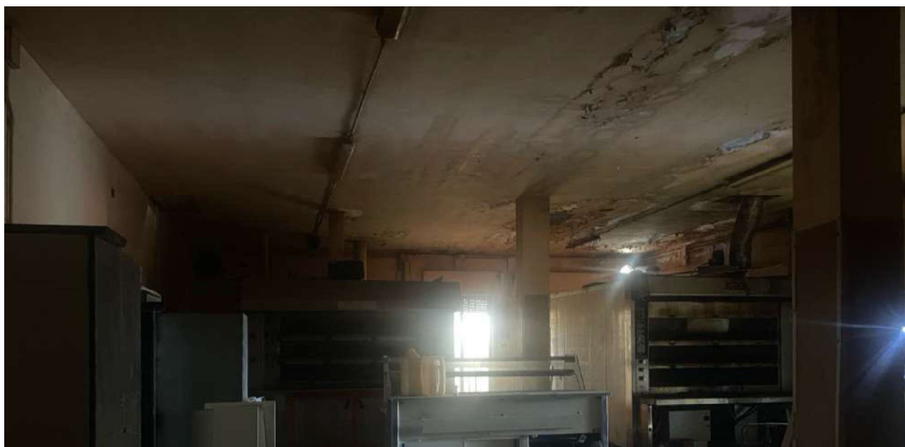
Figura 53: VISTA GENERALE INFILTRAZIONI NELLA ZONA DEI FORNI
