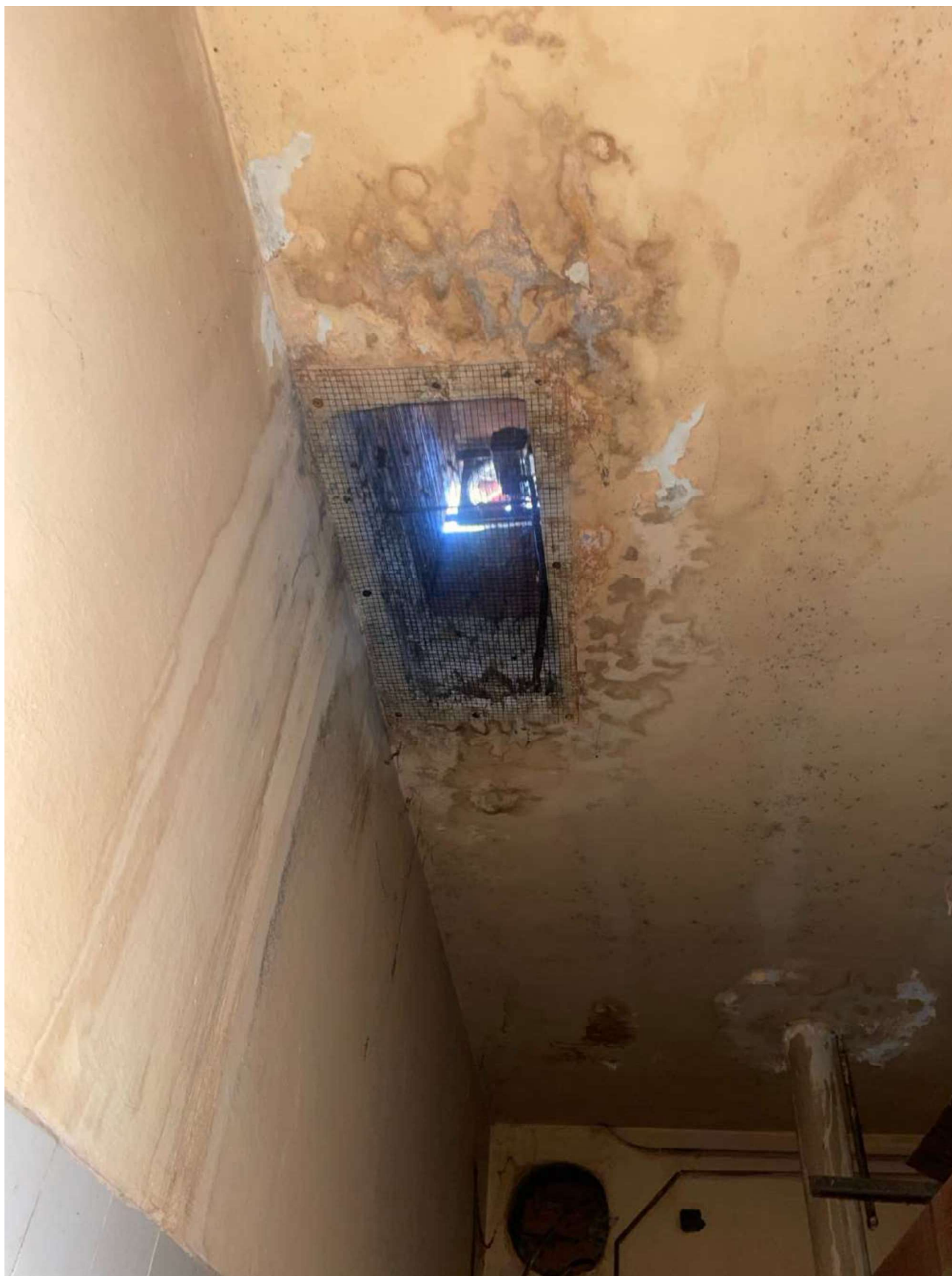
Figura 56: DETTAGLIO INFILTRAZIONI DAL PIANO DI COPERTURA ATTRAVERSO UN LUCERNAIO
