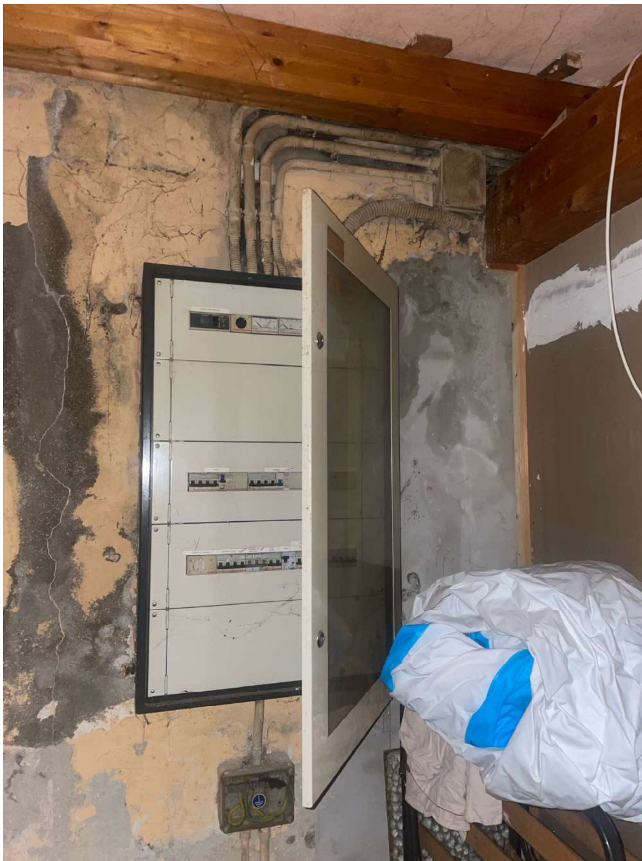
Figura 61: DETAGLIO QUADRO ELETTRICO
