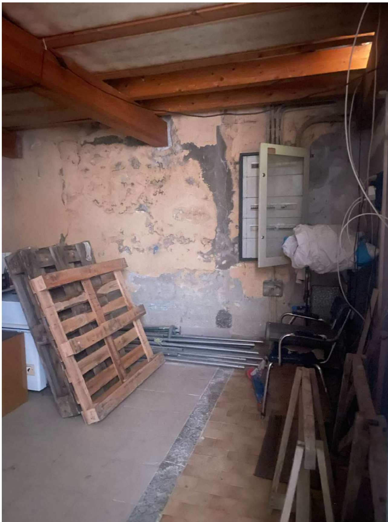
Figura 59: DETAGLIO INFILTRAZIONI DAL PROSPETTO PRINCIPALE NEL LOCALE DEPOSITO
