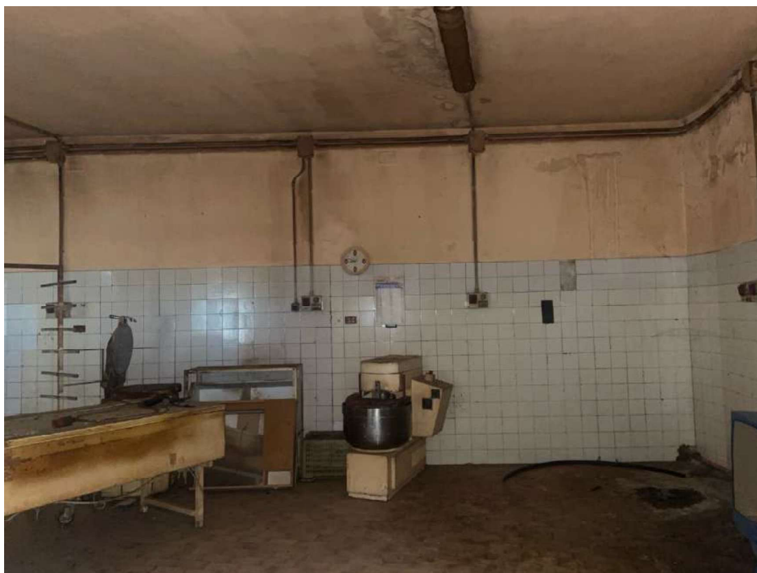
Figura 32-33: DETTAGLI INTERNI ZONA PANIFICAZIONE - IMPASTATRICE
